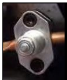
Robins de dérivation de conduite de réfrigération
