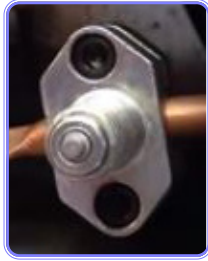
Válvula de toma de la línea de refrigeración
