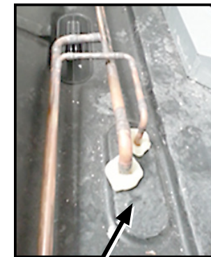
Sortie de tuyauterie
